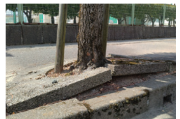
根上りによる植樹木の破損 (金津高校通学路)
